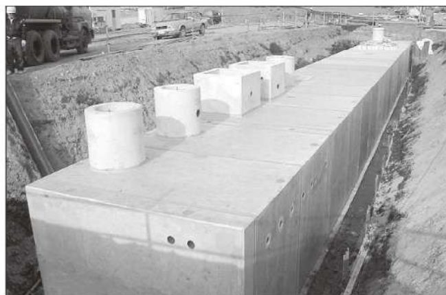
雨水利用多目的水槽 230m 3
